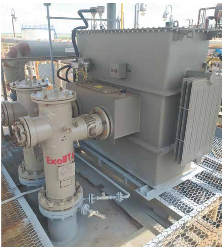
Пример модернизации системы электропитания электродегидратора на УПН «Аксеновская» ТПП «РИТЭК-Самара-Нафта» ООО «РИТЭК»
