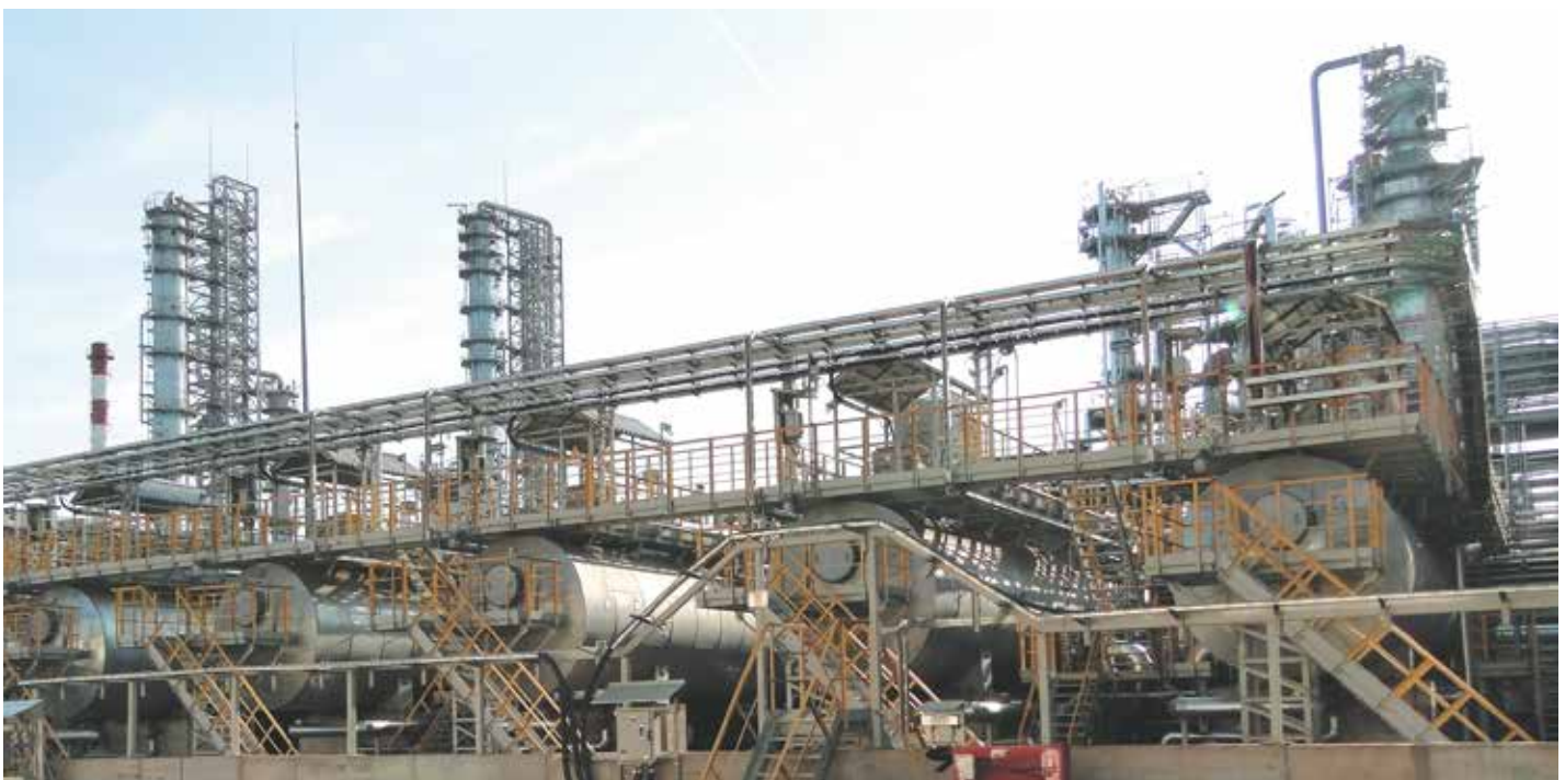
Блок ЭЛОУ с электродегидраторами и трансформаторами поставки ЗАО «Нефтех»
